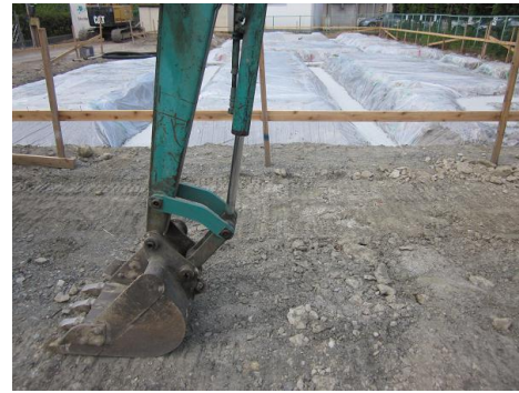
保守バプテスト同盟・泉聖書バプテスト教会 地震で教会の土台と斜面に亀裂が入り、斜面の修復工事を含む全面的な建て替えとなりました。(2012.8.23)
